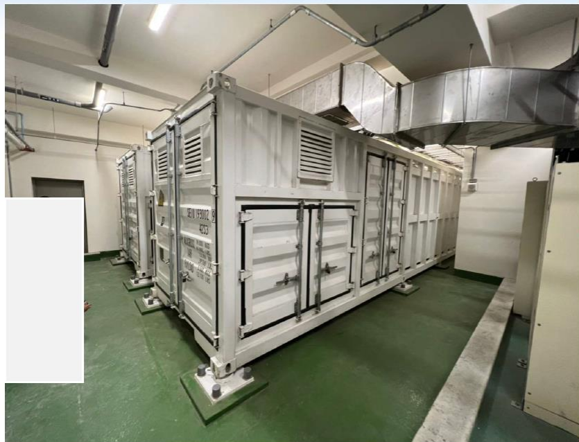
機房式室內儲能系統 (併大樓供電網)
